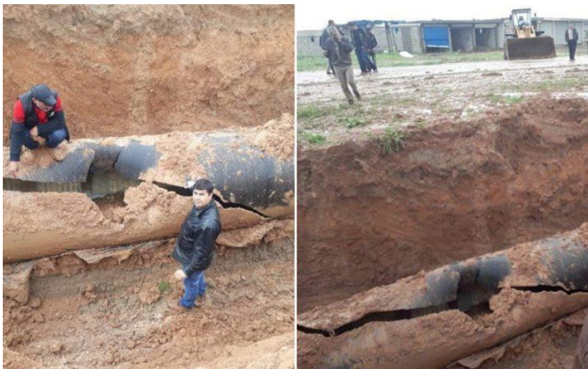
Zdjęcie (6): Główna rura wodna przepompowni Alok, która została wyłączona z eksploatacji przez ostrzał Turcji i jej sojuszników moździerzami i artylerią.
